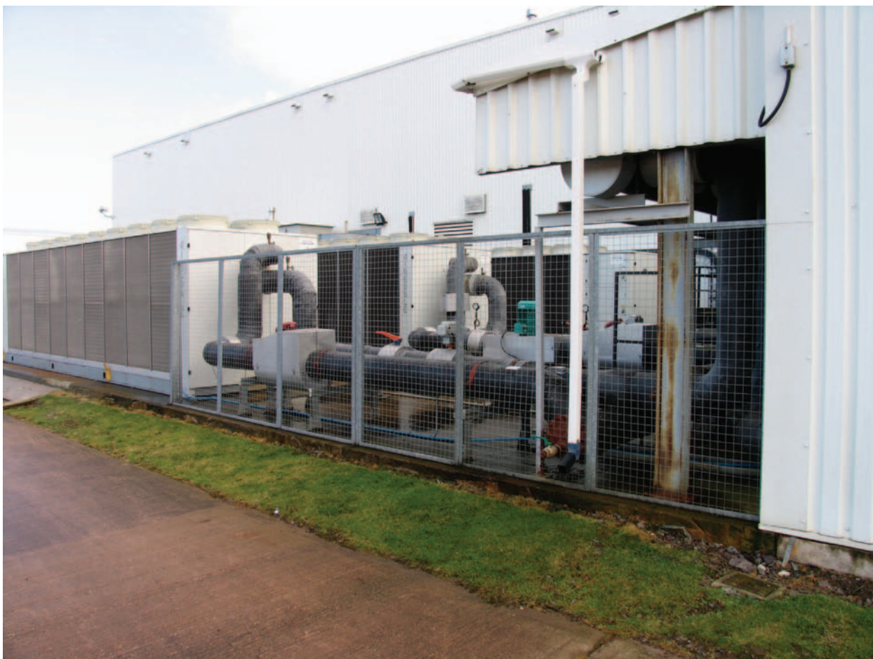
Рис. 14. Заводская компрессорная станция.
